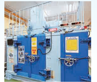
京都EBセンターで稼働中の電子線照射装置
