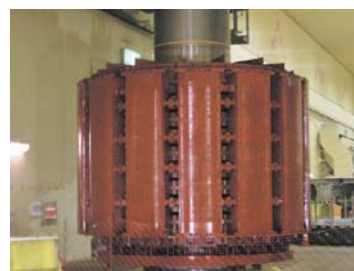
2 回転子は大きな電磁石。発電時は水車の力で回転し、揚水時はモーターとなってポンプ水車を動かす。
