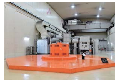
1 地下発電所の最上階。オレンジ部分が軸受を固定するブラケット。
