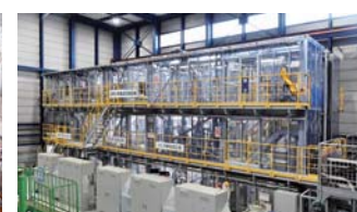
連続水素製造試験装置（水素プラント）
