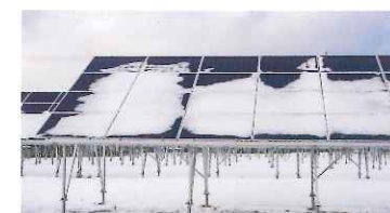
雪が降り積もった太陽光パネル
