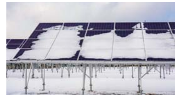
雪が降り積もった太陽光パネル
