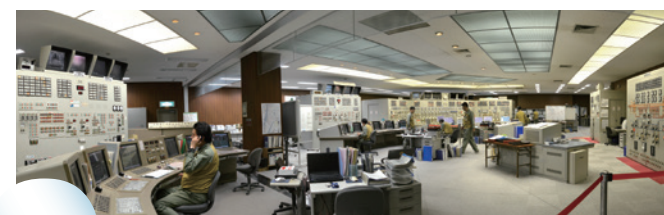
発電ユニットを24時間体制で管理・運用する制御室
