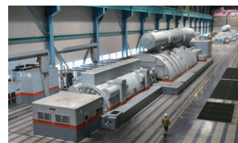
タービンと発電機がセットになった発電ユニット
