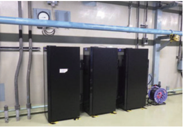
原子炉建屋の地下に設置されたミュー粒子検出器
